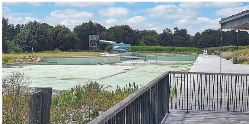
À Neuil-les-Aubiers, les bassins du Val de Scie sont désespérément vides. Les travaux sont attendus en 2026.
